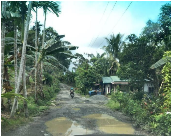
Gambar 2. Jalan rusak di Desa Sampe Raya
