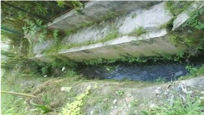
Gambar 2. Kondisi drainase yang tidak terawat
